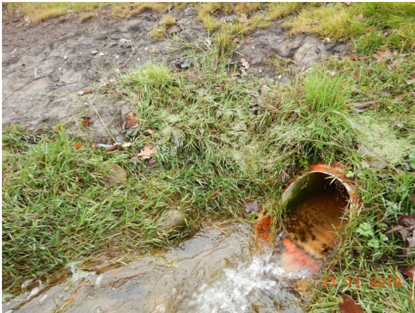
Figur 4.3 Drænrøret forsyner minivådområdet med vand.
