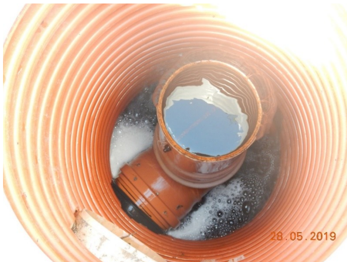
Figur 7.31 Iltningsbrønd som i Figur 7.29
